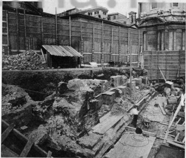
14. Scavo della Biblioteca a lato della Colonna Traiana (a d. si vedono le fondazioni dei pilastri in cemento che la sottosterrano) (1932).
