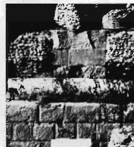
Le podium du temple d'Apollon formé par une structure en blocs de tuf de l'Aniene associée à du travertin et remplie de terre.
