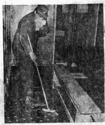
SI ENTRA CON LA MASCHERA - Soltanto con la maschera si può entrare nei locali di via Malfetta 23, dove ha sede un «distaccamento» della N.U. La rottura di un «tubo nero», infatti, ha causato un allagamento di liquame nauseabondo
