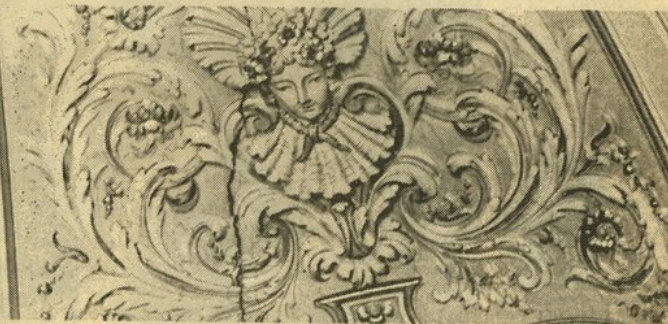
Gli stucchi e le crepe nella cupola della chiesa di San Celso in via del Banco di Santo Spirito
